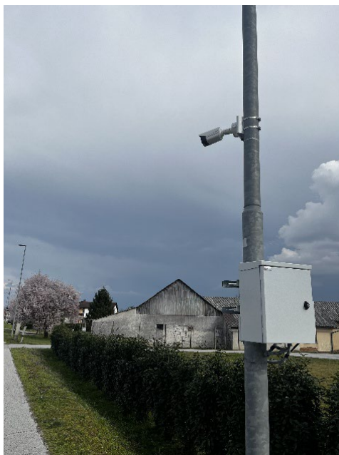
Slika 1: Sistem za samodejno zaznavanje in analizo varnostne razdalje, nameščen na ulično svetilko: kamera (zgoraj) in omarica z računalnikom ter hranilnikom energije (spodaj).
