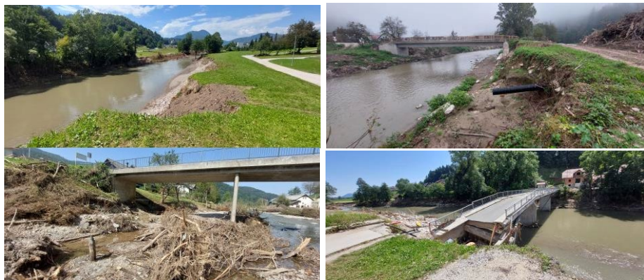
Slika 2: Poškodovane površine in infrastruktura
