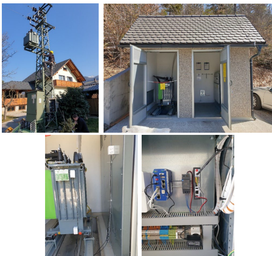
Slika 10: Namestitve merilne tehnike ob transformatorjih.
