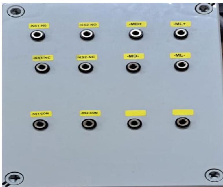
Slika 2: Priključna plošča, s pomočjo katere se bodo izvajale laboratorijske vaje
